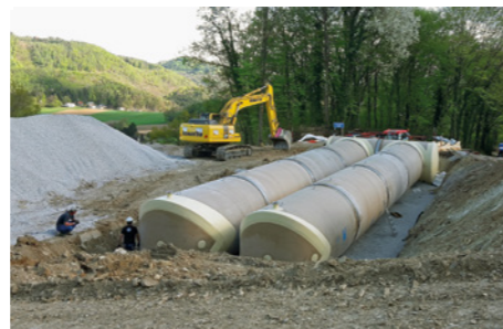
Oben: Transport der Fertigteile für den Hochbehälter Mitte: Versetzen der Fertigteile für den Hochbehälter Unten: Fertigstellung Hochbehälter Thal
